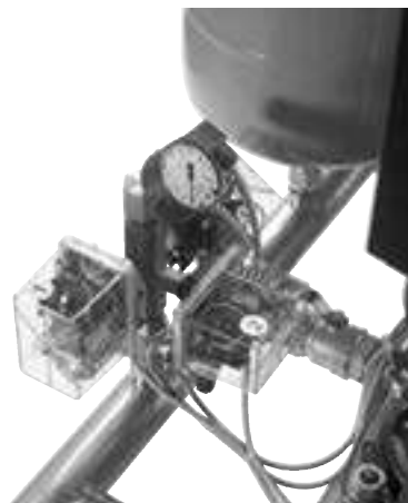
Рис. 21 Реле давления, установленные на коллекторе
